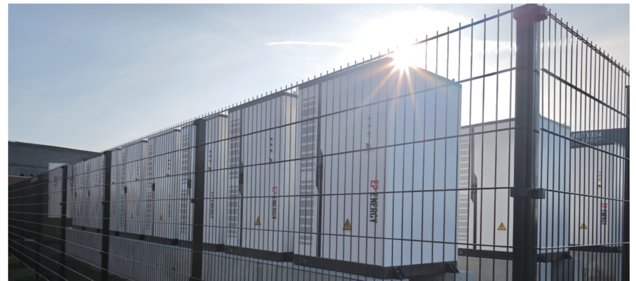
Zonnebeke, Belgium C&I BESS
